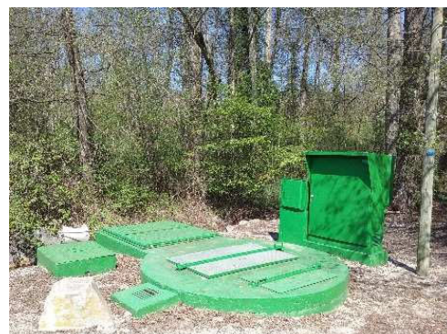
Photo 16 : Poste de refoulement Marais de Lépin gare
