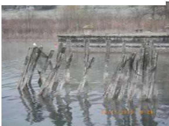
Photo 25: Frayère très dégradée
